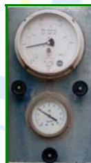
Indicadores de nivel y presión del tanque
