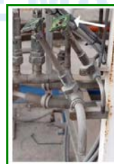
Válvulas de escape de gas
